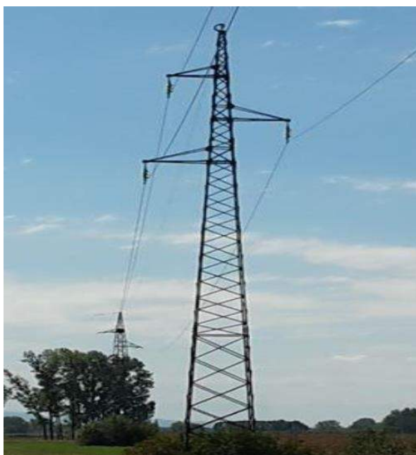
Slika 1.2-3: Jednostruko čelično-rešetkasti stup „jela“
